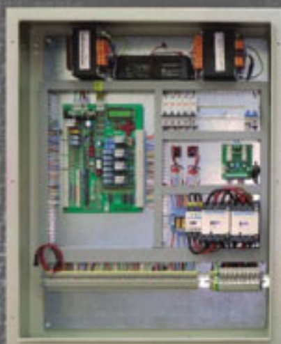
Ηλεκτρονικός Πίνακας Μηχανικού & Υδραυλικού Ανελκυστήρα
